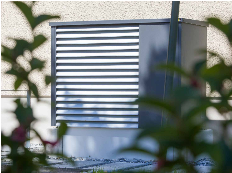
Abbildung 3: Außenaufstellung einer Luftwärmepumpe für ein Mehrwohnungsgebäude.
